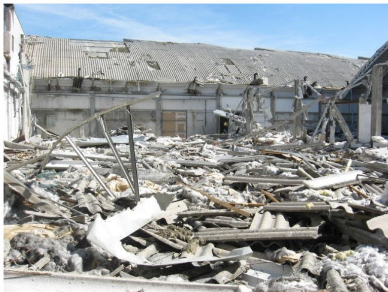
Figura 23 Crollo e dispersione della copertura in cemento-amianto a Cerreto Guidi – settembre 2014
